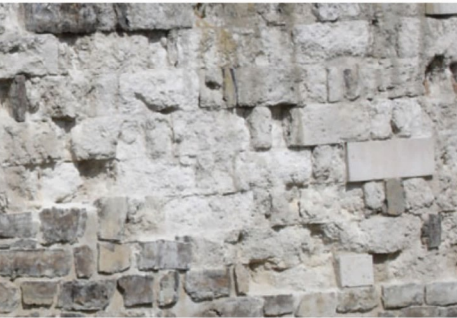
Deterioro diferencial de los materiales de la muralla.
